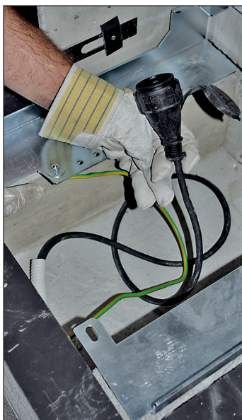
Vollständige Ansicht Bodenbereich mit bauseitigen Zuleitungen
